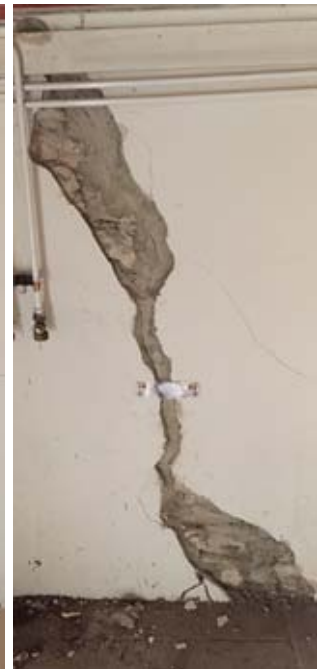
am 25.11.2020 Geschlossener Riss
